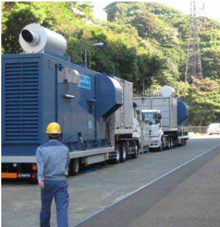
空冷式非常用発電装置
