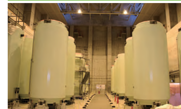
所在地: 茨城県那珂郡東海村 運用開始: 2001年 貯蔵方式: 乾式貯蔵方式 建屋規模: 54m×26m×(高さ) 21m 貯蔵容量: 約250tU
