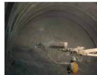
石炭灰を使用した吹付けコンクリート (トンネル施工状況) 提供：北海道電力株式会社
