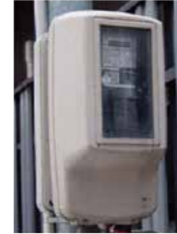
計器箱設置状態
