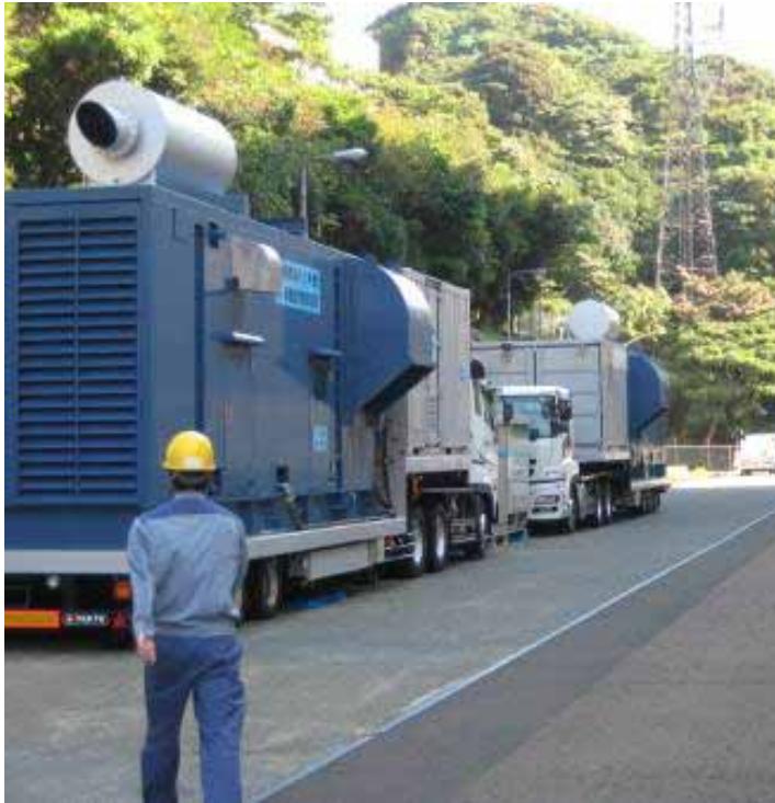
空冷式非常用発電装置
