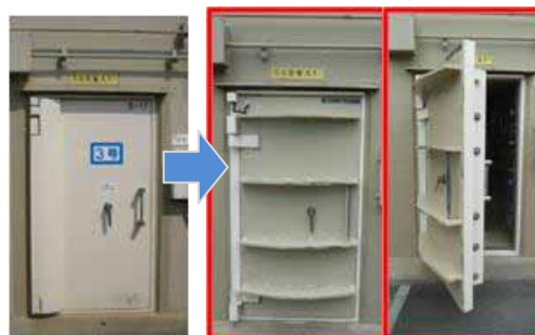
建屋防水扉の強化
