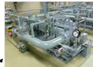
補給水ポンプ (高台に設置された空冷式 発電機からの電源供給)
