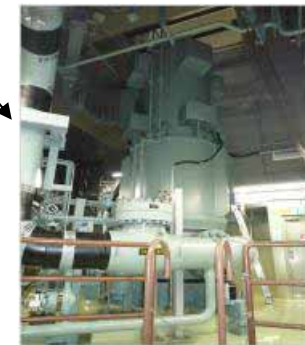
高圧注水ポンプ (空冷式熱交換器を用いたモータ 冷却/高台に設置された空冷式 発電機からの電源供給)
