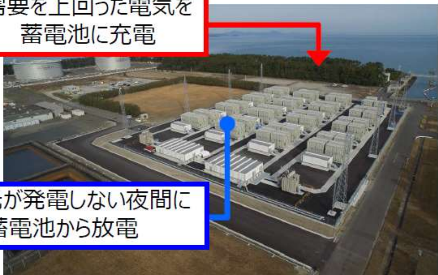
〔豊前蓄電池変電所〕
