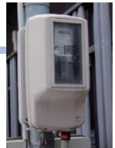
計器箱設置状態
