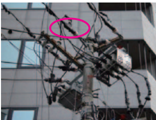
絶縁カバー設置状態
