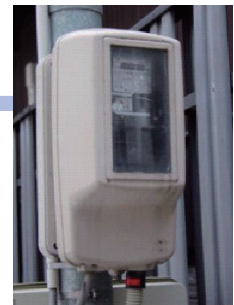
計器箱設置状態
