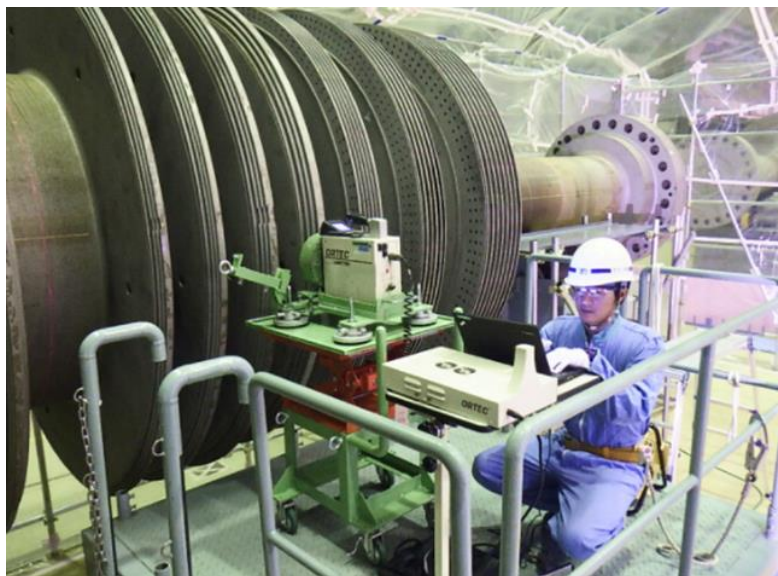
浜岡5号機タービンロータの クリアランス測定
