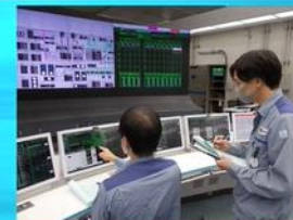
デジタル制御室での監視・操作
