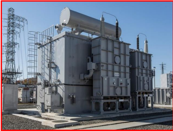
超高压変圧器 (例)
