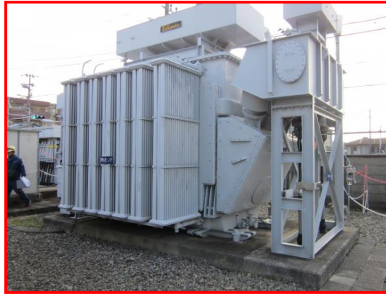
配電用変圧器 (例)
