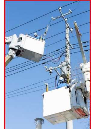
柱上変圧器 (例)
