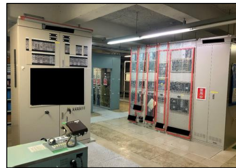
監視建屋や継電器建屋などの制御盤
