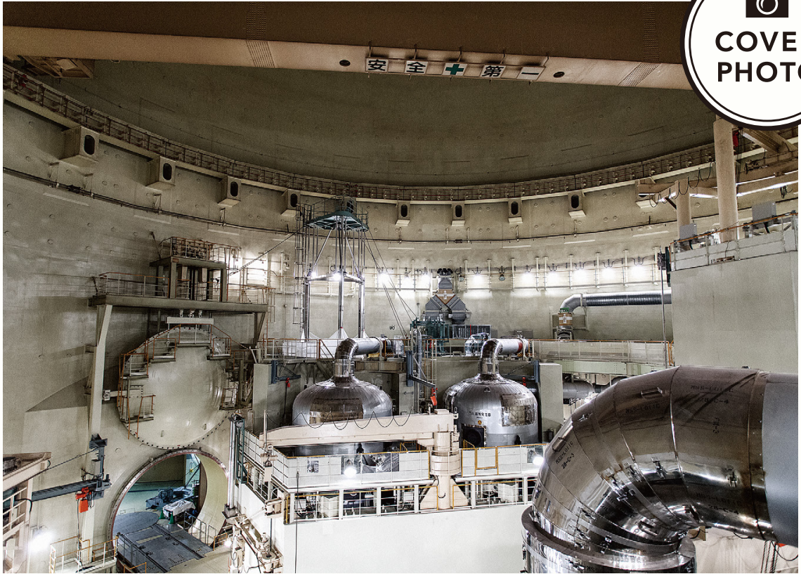
九州電力玄海原子力発電所3号機の格納容器内部
