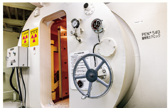
格納容器入口にある二重扉式のエアロック
