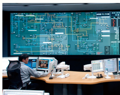
中央給電指令所(九州電力)
