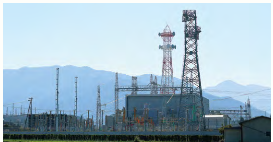
新信濃変電所 提供：電気新聞
