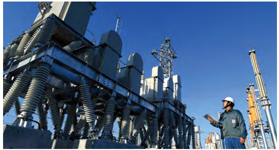
新信濃変電所構内に新設された直流設備 提供：電気新聞
