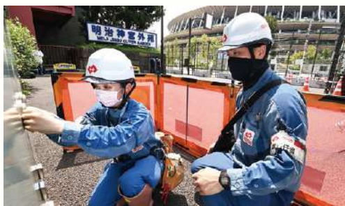
点検後、開閉部に封印テープを貼る東京電力パワーグリッドの社員 提供：電気新聞
