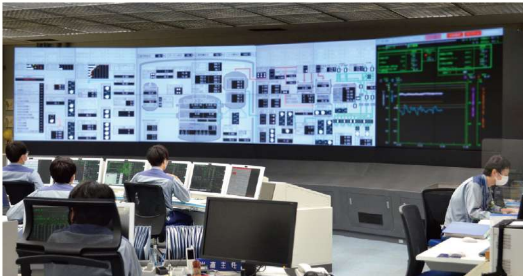
原子炉を起動した美浜3号機の中央制御室。安全対策の一環で制御盤などがデジタル化された
