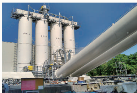
金武火力発電所の木質バイオマス燃料供給設備 提供:沖縄電力
