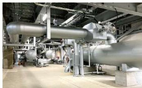
タービンを回すための蒸気を作り出すボイラ
