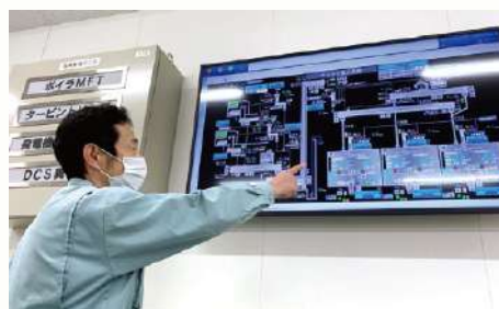
設備の状態を監視する中央操作室
