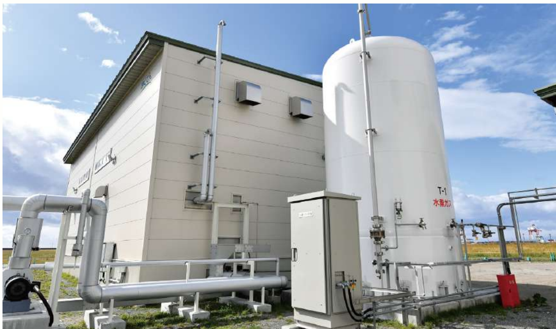
苫東厚真発電所の隣接地にある水素製造装置の建屋と水素を貯蔵するタンク
