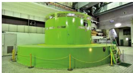
2号機の発電電動機
