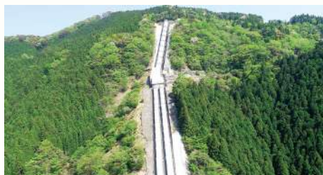
上部ダムから水車に水を送り込む水圧鉄管 提供:九州電力
