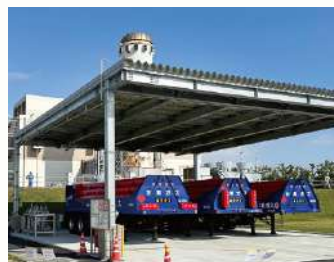
発電所に圧縮水素を供給する トレーラー
