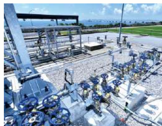
水素と天然ガスを適切な比率で 混合するための水素供給設備
