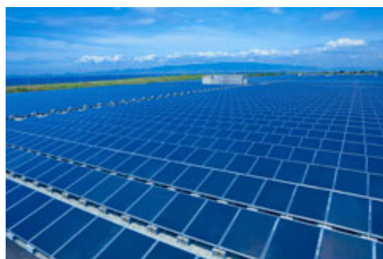
メガソーラー発電所 (出典：関西電力株式会社)
