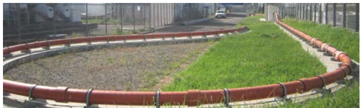
超電導ケーブル運転実証
