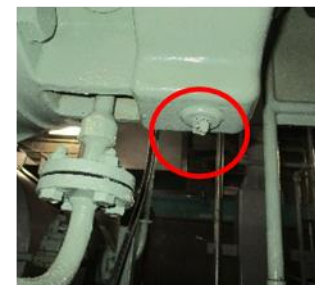
抜油口（写真①）
