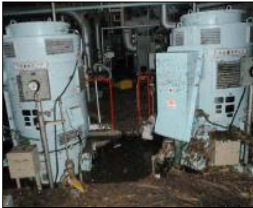
(写真1) 復水ポンプ（電動機）の被害
