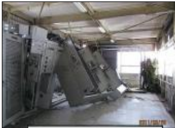
(写真3) 制御盤の被害
