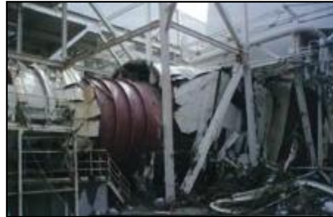
(写真2) 通風機の被害
