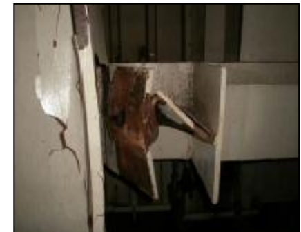
(写真3) ボイラー鉄骨の変形
