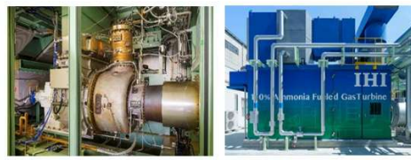
IHI製アンモニア専焼2MW級ガスタービン 相生事業所における実証試験設備
