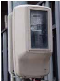
計器箱設置状態
