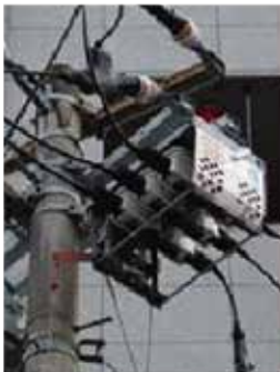
絶縁カバー設置状態
