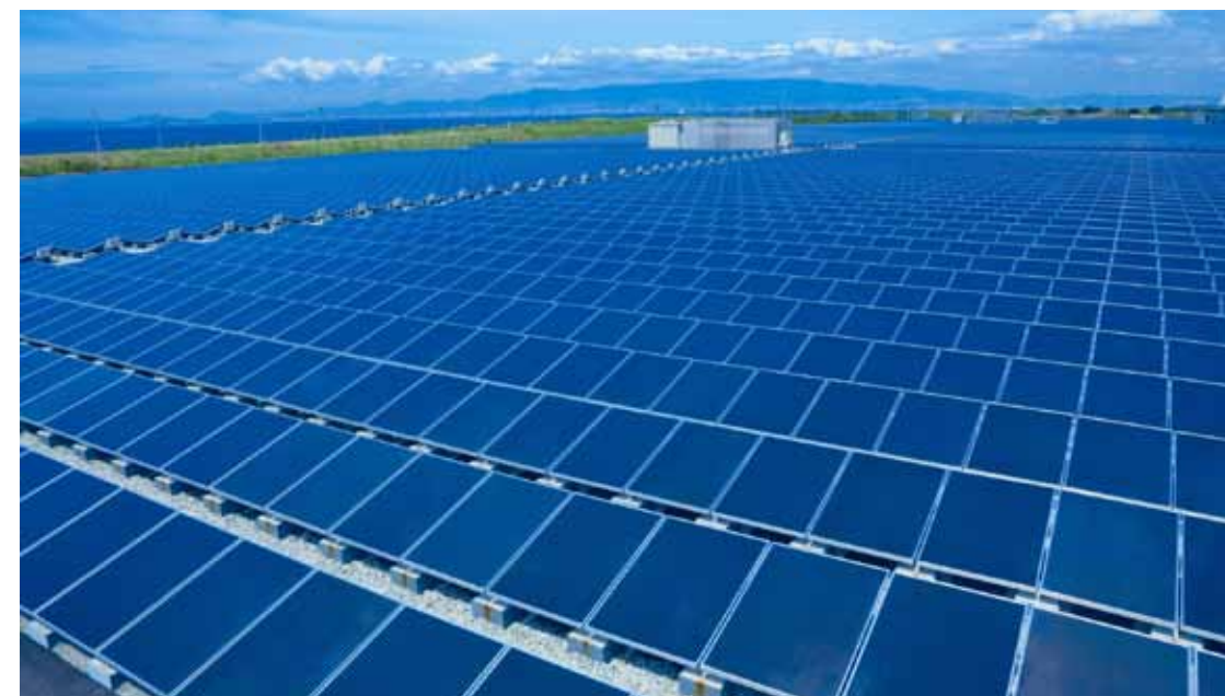
関西電力：堺太陽光発電所（2011 年 9 月運開）
