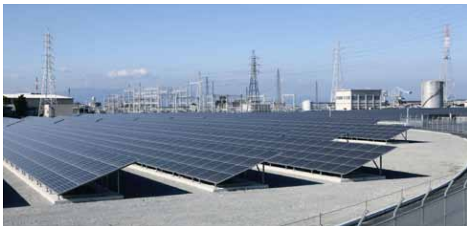
九州電力：メガソーラー大牟田発電所（2010 年 11 月運開）
