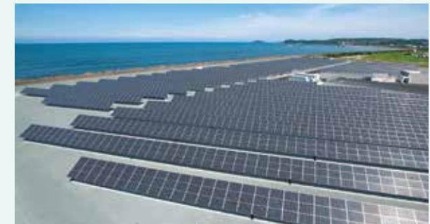
三國太陽光発電所
