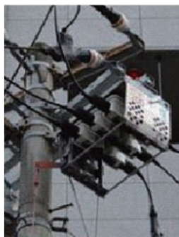
絶縁カバー設置状態
