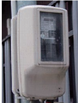
計器箱設置状態
