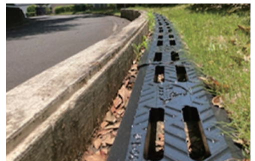
原子力発電所敷地内の側溝用金属蓋
